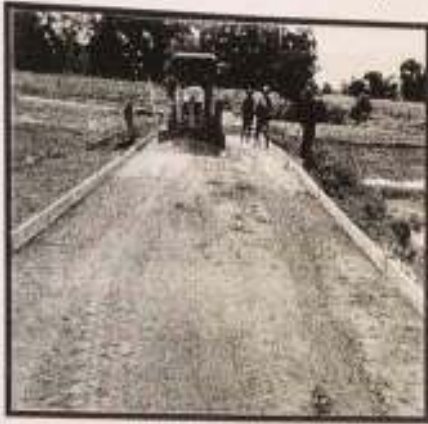
ก่อสร้างถนนคอนกรีตเสริมเหล็ก หมู่ที่ ๑๔ บ้านจิ้งหิ้น
