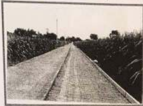
ก่อสร้างถนนคอนกรีตเสริมเหล็ก หมู่ที่ ๘ บ้านหนองคูมน้อย
